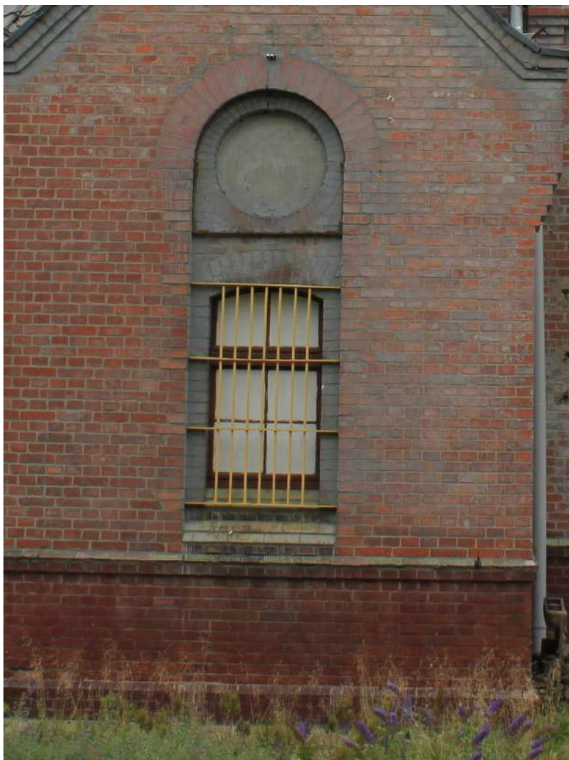
Fot. nr 27. Kuźnia ul. Monte Cassino 4, Olsztyn. Koszary Artylerii wybudowane w I fazie 1888-1889. Elewacja południowo-wschodnia, Jedyna zachowana drewniana oryginalna stolarka z II fazy budowlanej, bardzo zniszczona, będzie stanowiła wzór dla rekonstrukcji czterech okien znajdujących się w ryzalitach budynku.
