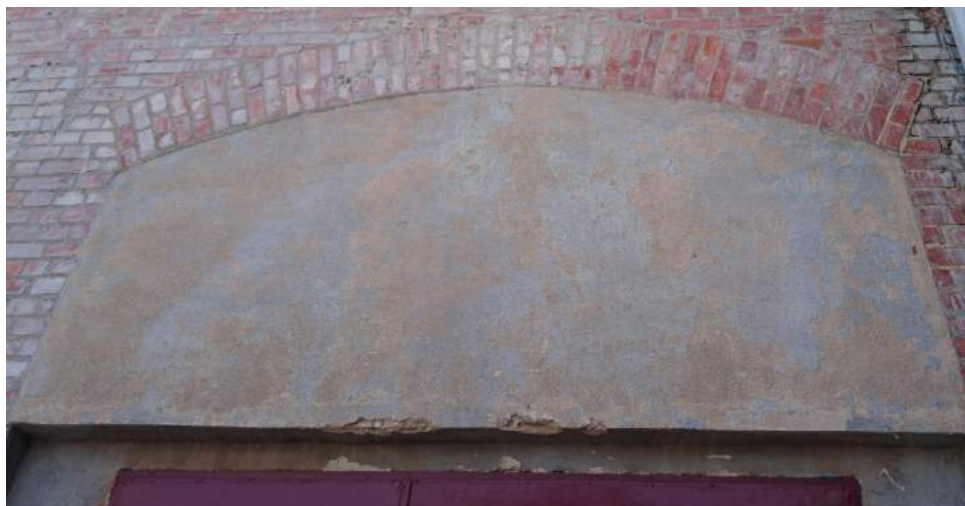
Fot. nr 39. Kuźnia ul. Monte Cassino 4, Olsztyn. Koszary Artylerii wybudowane w I fazie 1888-1889. Elewacja północno-zachodnia przekształcone wejście wjazdu bocznego do kuźni. Zamurowany otwór, zmniejszony z wprowadzeniem dwuteownika w nadprożu i blaszanych dwuskrzydłowych drzwi pomalowanych na czerwono, tynk cementowo-wapienny.
