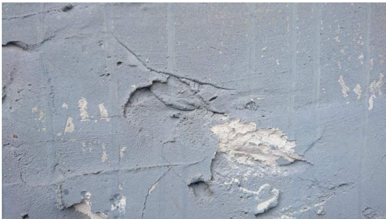
Fot. nr 33. Kuźnia ul. Monte Cassino 4, Olsztyn. Koszary Artylerii wybudowane w I fazie 1888-1889. Elewacja południowo-wschodnia, wtórny tynk leżący w zamurowanym okulusie z szarą warstwą malarską. Poniżej ta sama warstwa malarska po mikroskopem.
