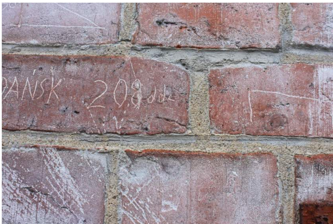
Fot. nr 29. Kuźnia ul. Monte Cassino 4, Olsztyn. Koszary Artylerii wybudowane w I fazie 1888-1889. Elewacja południowo-wschodnia. Oryginalna zaprawa spajająca watek z I fazy budowlanej z odcisniętym żelazkiem w mokrej zaprawie służącym do fugowania. Wyryte napisy niektóre historyczne wymagają pozostawienia!
