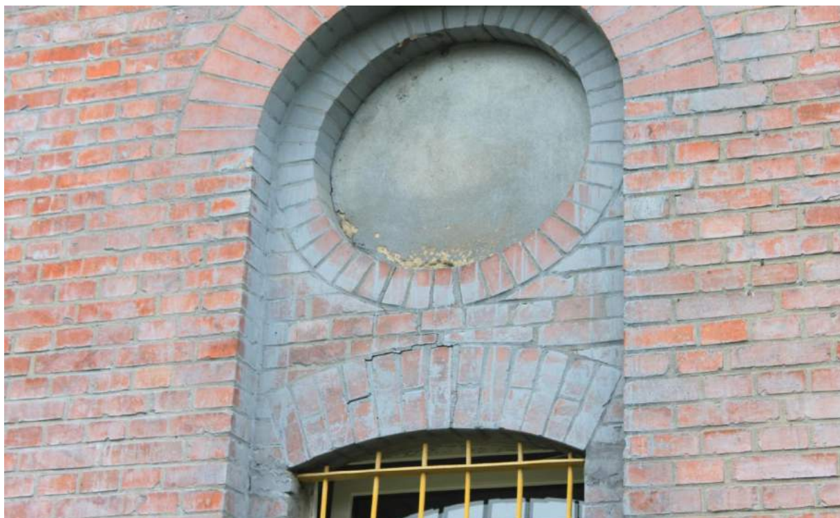
Fot. nr 21. Kuźnia ul. Monte Cassino 4, Olsztyn. Koszary Artylerii wybudowane w I fazie 1888-1889. Elewacja południowo-wschodnia. Widoczny wątek ceglany zamalowany na szary kolor farbą emulsyjną, zniekształcający pierwotny kolor i odcienie czerwieni cegieł na elewacjach. W okulusie zamurówka i tynk cementowy wtórny, poniżej współczesne okno.
