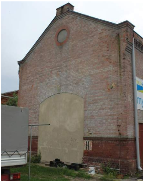
Fot. nr 12. Kuźnia ul. Monte Cassino 4, Olsztyn. Koszary Artylerii wybudowane w I fazie 1888-1889. Elewacja północno-wschodnia. Zamurowany otwór wyjazdowy z wnętrza kuźni. Tynk cementowy współczesny. Widoczne przemalowania powierzchni wątku ceglanego, liczne przemurowania i wadliwe uzupełnienia cokołu zniszczonego z powodu silnego zalewania wodą opadową i przemarzaniem powierzchni.
