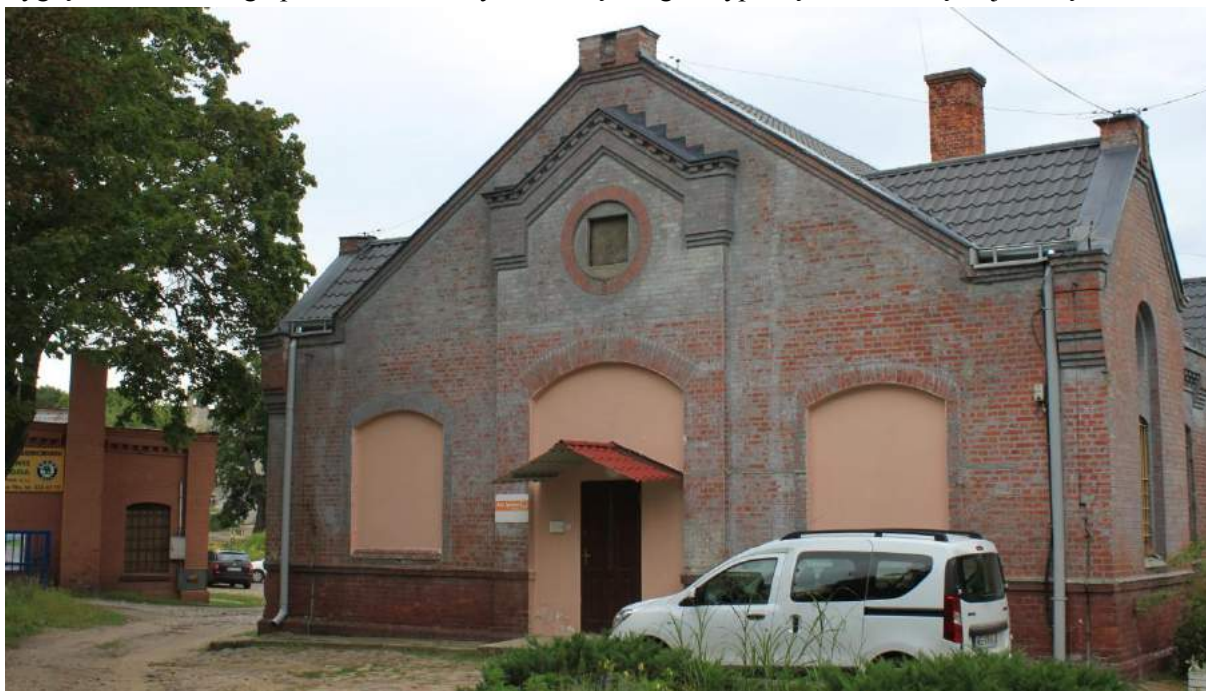
Fot.nr 1. Kuźnia ul. Monte Cassino 4, Olsztyn. Koszary Artylerii wybudowane w I fazie 1888-1889. Elewacja południowo-zachodnia. Widoczne zniszczenia elewacji spowodowane przemalowaniem farbami emulsyjnymi. Ubytki spoinowania w parapetach i cokole spowodowane wpływem znacznego zawilgocenia dolnych partii budynku. Zamurowanie otworów okiennych i wjazdu do wnętrza kuźni. Widoczne ukształtowanie terenu wokół z zachowanym brukiem.
